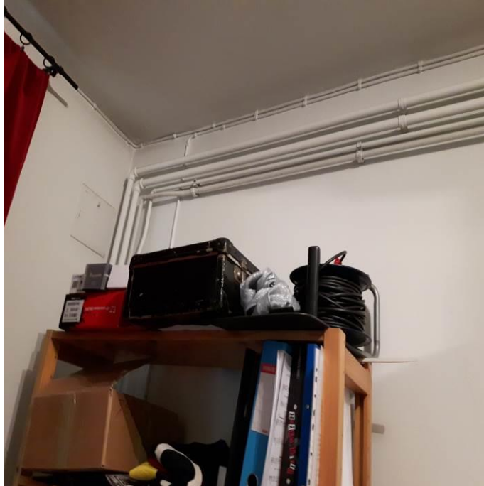
Kuva 34. Kärysaunan vesi- ja lämpöjohdot.
