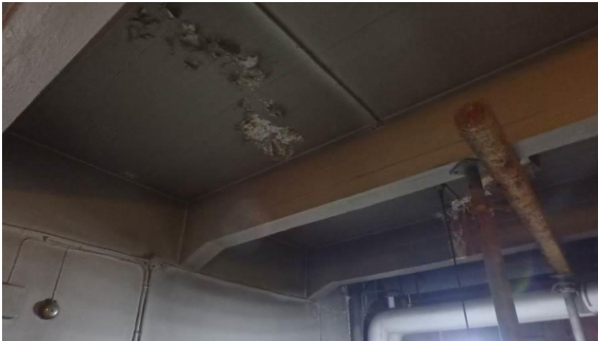
Kuva 32. Lämpökeskuksen kattopinnan maali hilseilee vesivuodon takia.
