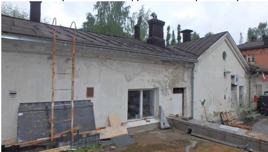
Kuva 12. Mehuaseman rappauksissa on kosteuden aiheuttamia vaurioita.
