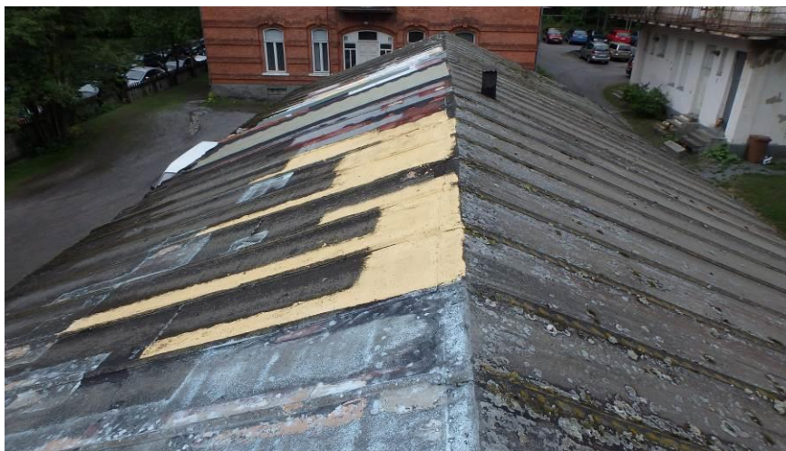
Kuva 25. Mehuaseman kattuhuovalla katettu katto.
