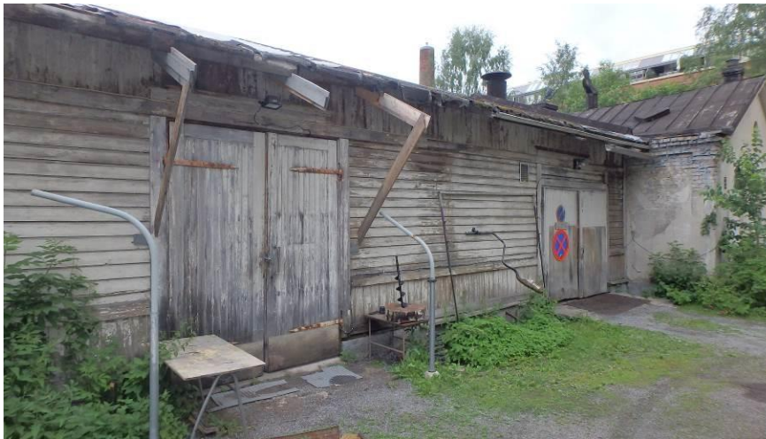
Kuva 14. Kylmän varaston puuverhouksen maalipinnat ovat kuluneet.
