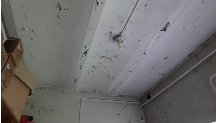
Kuva 31. Mehuaseman sisäkaton maali hilseilee.
