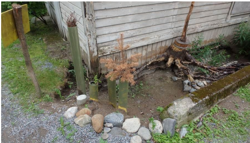
Kuva 5. Kylmän varaston sokkeli ja puuverhottu julkisivu ovat jääneet osin ympärystäytön alapuolelle.
