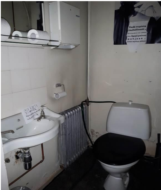
Kuva 39. Mehuaseman vesikalusteet ja lämpöpatteri(50 luvulta).
