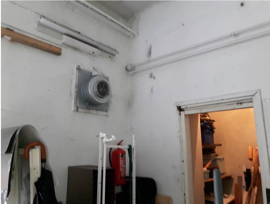
Kuva 43. Mehuasemalla seinäasenteinen puhallin.
