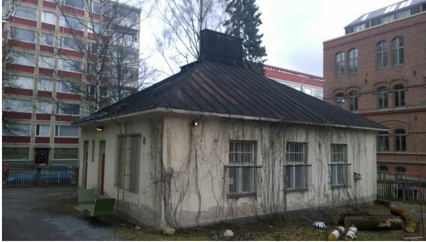
Kuva 10. Kärysaunan julkisivujen alaosassa on vaurioita rappauspinnassa.
