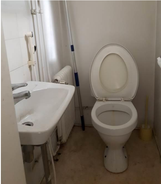
Kuva 38. Kärysaunan vesikalusteet (80-luvulta) ja lämpöpatteri (50-luvulta).
