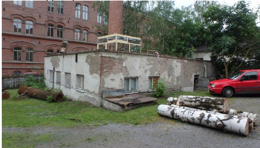
Kuva 11. Lämpökeskuksen rappaukset ovat pahoin rapautuneet.
